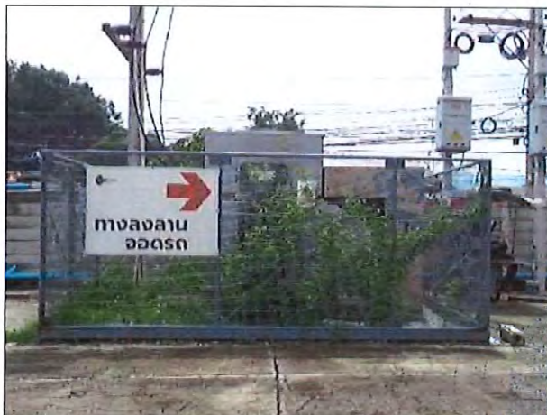
หม้อแปลงไฟฟ้า
