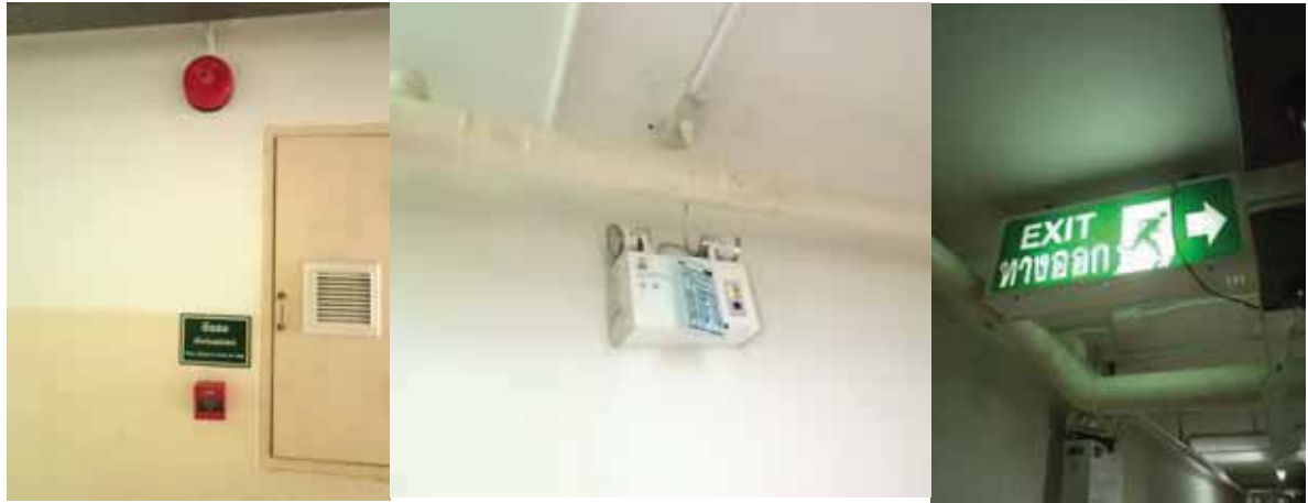
สภาพงานระบบป้องกันอัคคีภัย บริเวณพื้นที่เซอริวิส อพาร์ทเมนท์
