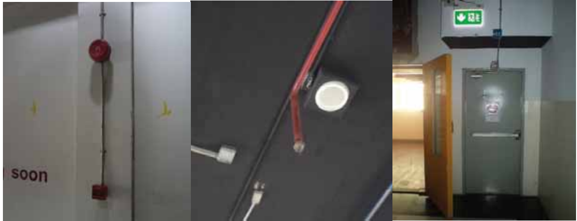
สภาพงานระบบป้องกันอัคคีภัย บริเวณพื้นที่พลาซ่า
