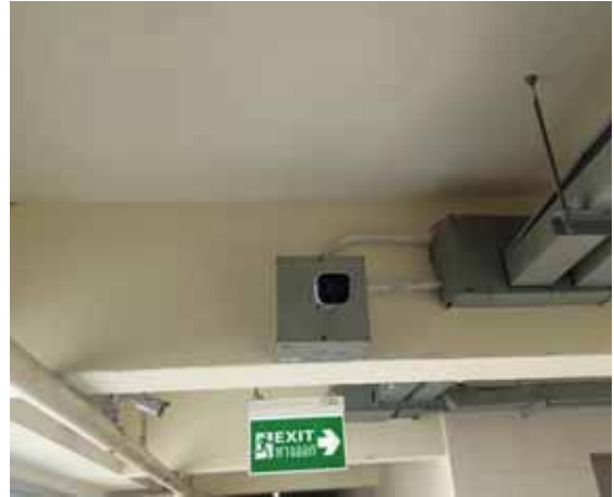
สภาพงานระบบวงจรปิด บริเวณพื้นที่หอพัก
